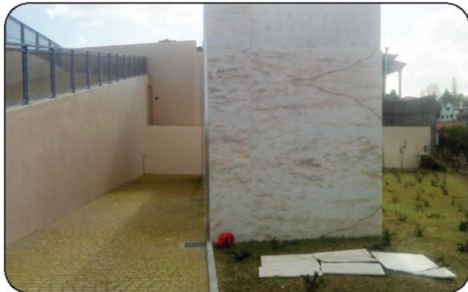
Más notícias em torno do cemitério sucedem-se. Há cerca de duas semanas uma laje do revestimento das novas capelas caiu...
