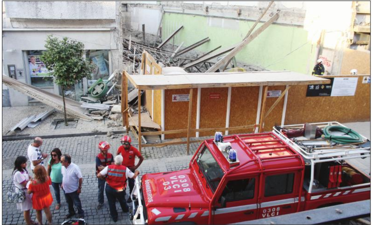
O edifício da farmácia Barbosa veio abaixo. Na origem da derrocada deverão estar as obras a decorrer no edifício vizinho. Quatro funcionários e dois clientes escaparam com ferimentos ligeiros e um grande susto. (Pág.3)
