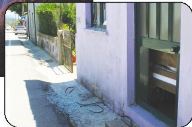
Vidros partidos e portas destruídas foram o balanço da explosão
